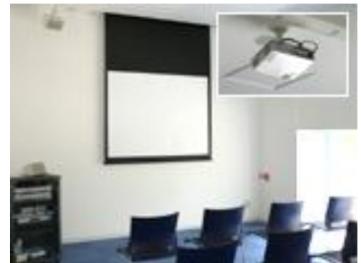
【 映像音響設備 】
